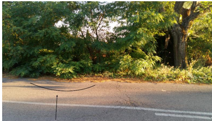
Ilustración 34 ONDULACION EN EL ASFALTO
