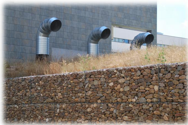
Figura 30. Toma de Aire a la entrada de la instalación.
