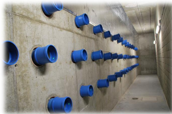
Figura 31. Imagen de la salida de aire de los pozos a la cavidad anterior a la UTA.
