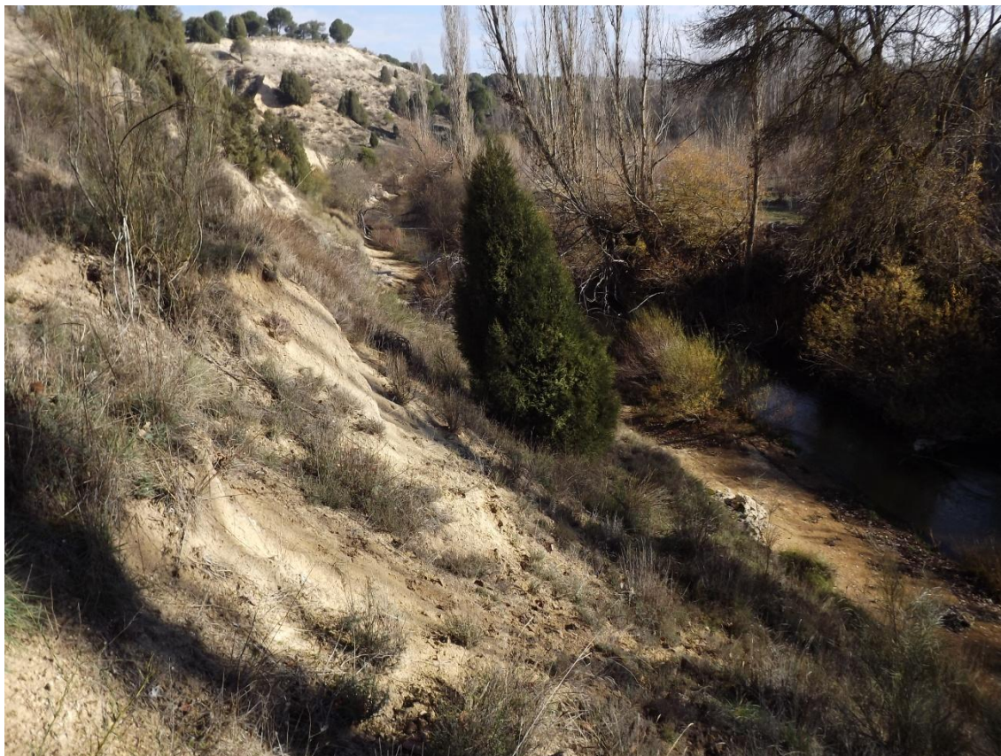
Figura 16: Margen derecho del tramo 3, donde el cauce llega casi hasta la ladera natural.
