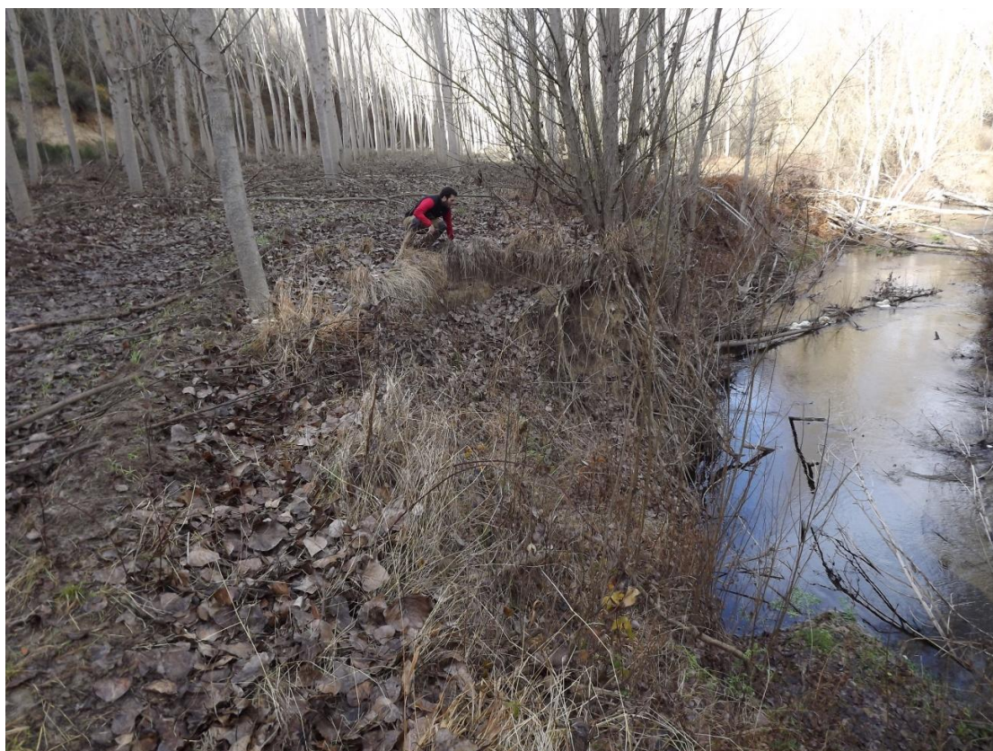
Figura 19: Signos de inestabilidad en el talud producidos por la erosión del cauce en épocas de crecidas.
