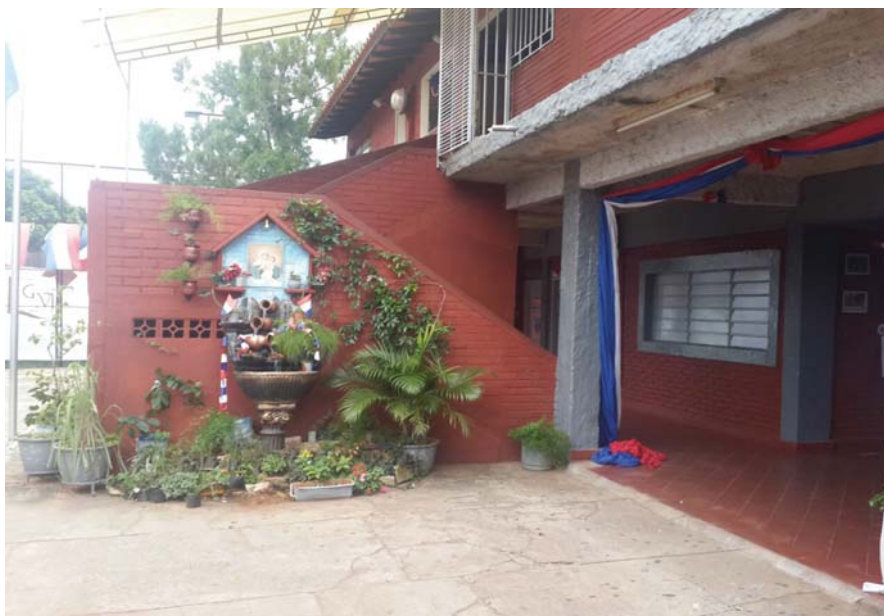
Escalera que conduce a la segunda planta del edificio. No cuentan con un mecanismo de accesibilidad universal para el efecto.
