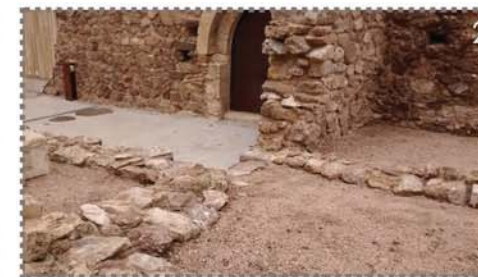
2 Hormigonado en zona de acceso a taller, sin seguir los parámetros de preservación presentes en el resto del conjunto.
