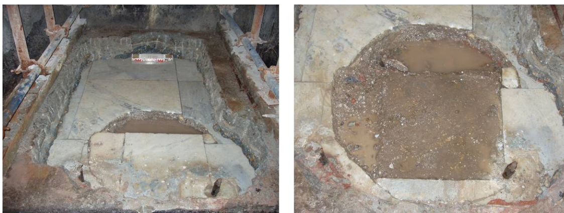
Fig. 70.- Detalle del círculo de mármol incompleto encontrado al retirar la gruesa capa de hormigón del suelo de la cripta. Se corresponde con el elemento marcado con la letra F en el plano de Butler, aunque por el extraño planteamiento de las losas parece como que o bien se retirara sobre la marcha, o que se retirara con posterioridad y después se tapara. Fotografías del doctorando.
