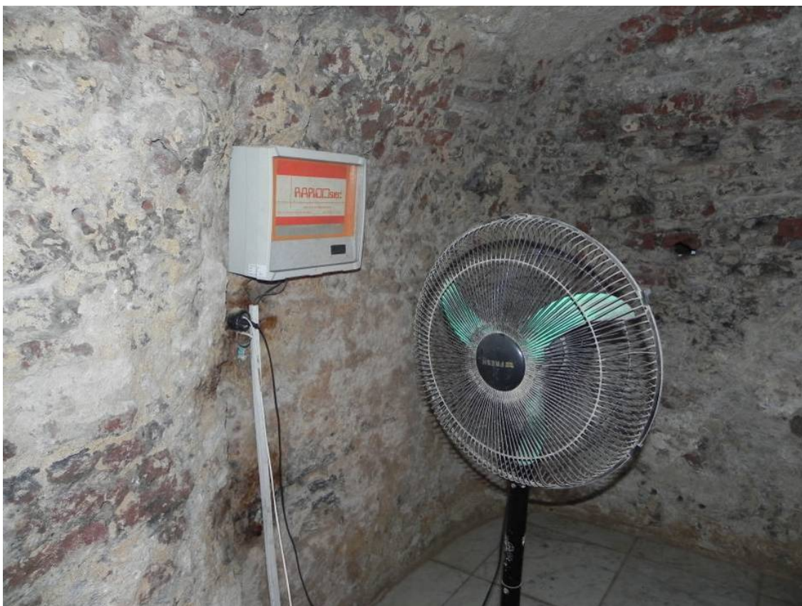
Fig. 338.- Sistema RAPIDOsec instalado en la cripta de Abu Sirga para favorecer su secado a la vista de la humedad persistente en los muros después de la restauración. Fotografía del doctorando.
