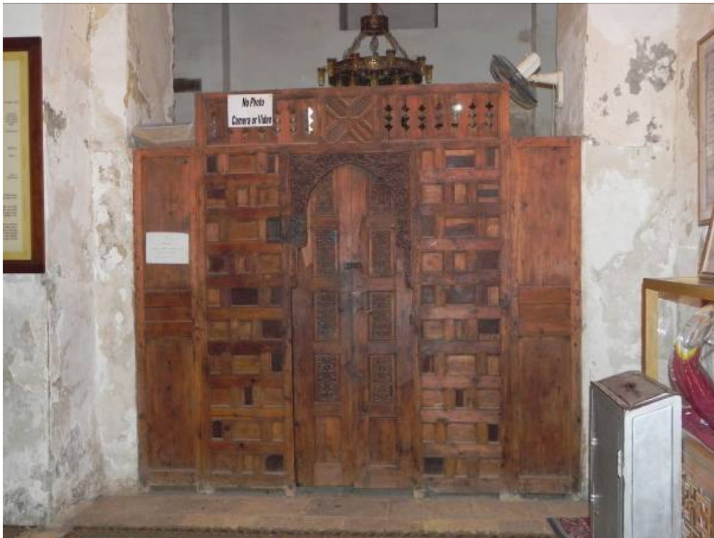
Fig. 121.- Panel de madera que acota la actual capilla del baptisterio de Abu Sirga. Fotografía del doctorando.
