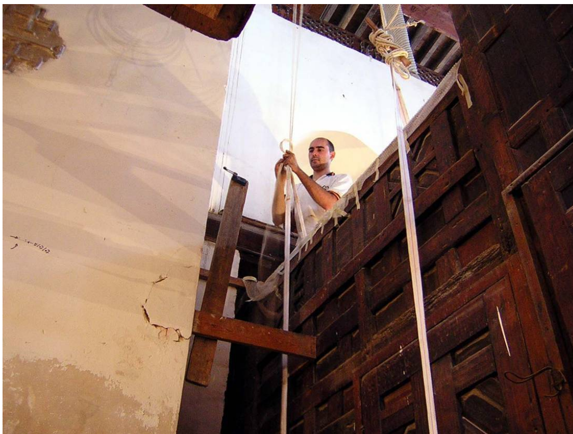
Fig. 329.- Detalle del tensado de las cintas de nylon con las cuerdas conectadas a las vigas del techo. Fotografía de Jesús Arenas.
