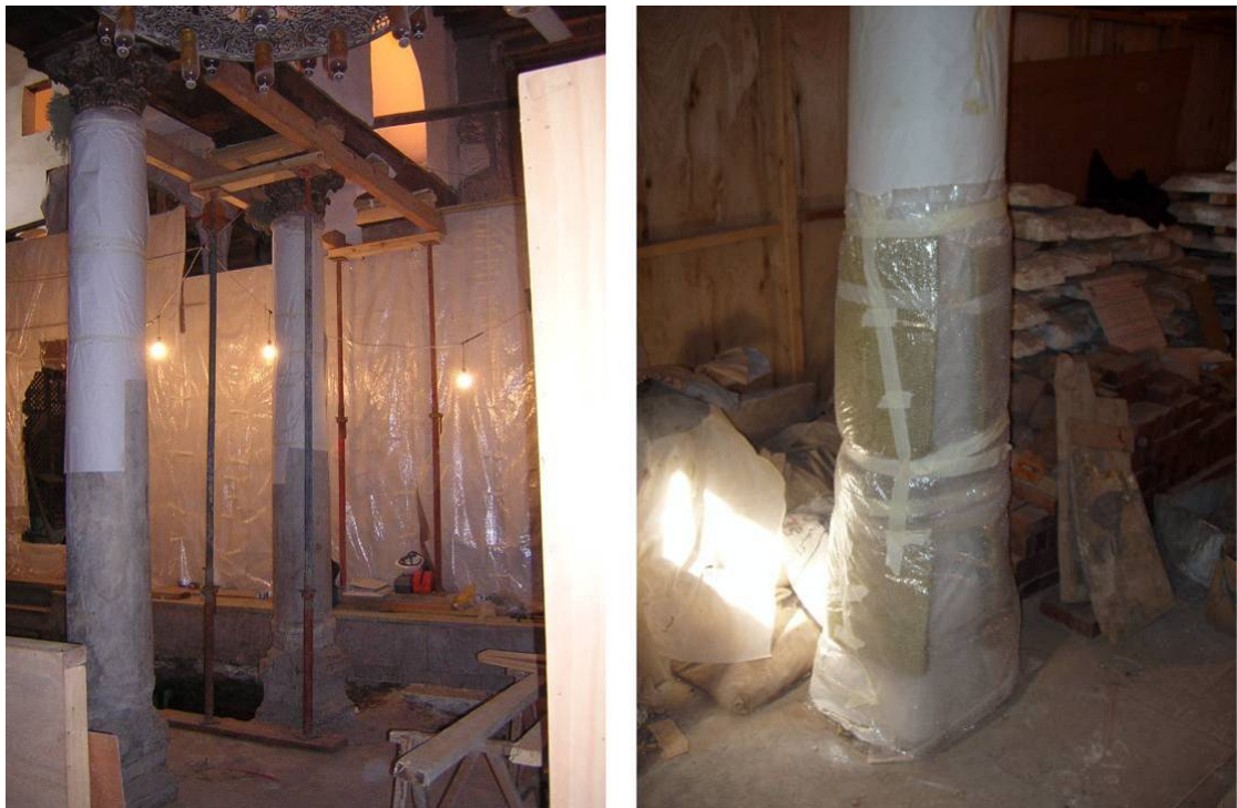
Fig. 331.- Protecciones de los iconostasios, del entablamento de madera y de las columnas durante el desarrollo de los trabajos arqueológicos. Fotografías del doctorando.
