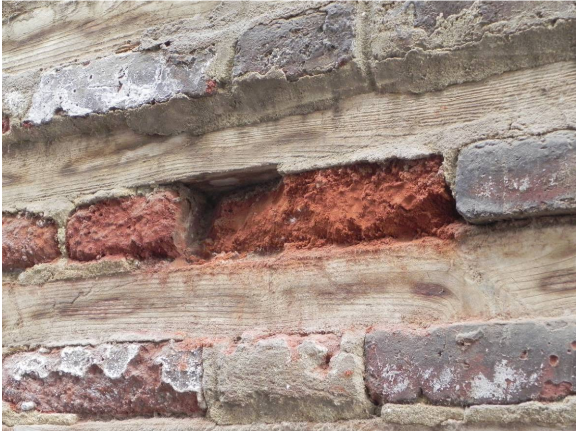
Fig. 321.- Ladrillo arenizado en la fachada oeste de la iglesia de San Sergio, consecuencia de un defecto en su fabricación. Fotografía del doctorando.
