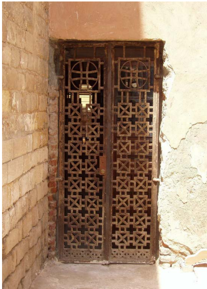
Fig. 91.- Puerta de acceso al patio desde el tramo central de la nave derecha vista desde el exterior. Fotografía del doctorando.
