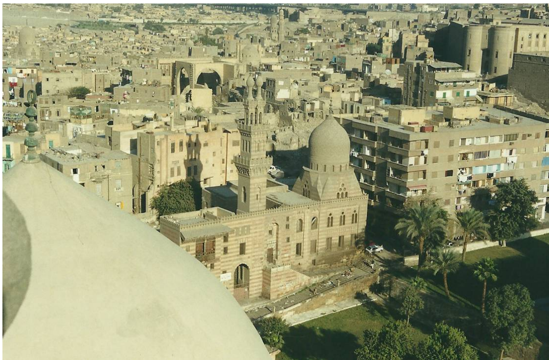
Fig. 243.- Mezquita del sultán Qaytbay vista desde el minarete de la mezquita del Sultán Hassan. Está cerrada al público desde el terremoto de 1992 por encontrarse apuntalada por el interior. Fotografía del doctorando.
