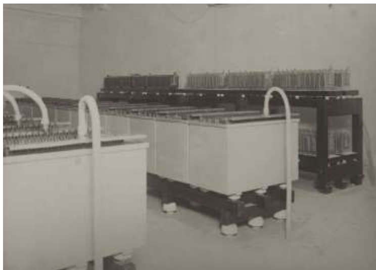
(241) Sala de baterías en los sótanos de la Central 41 .
