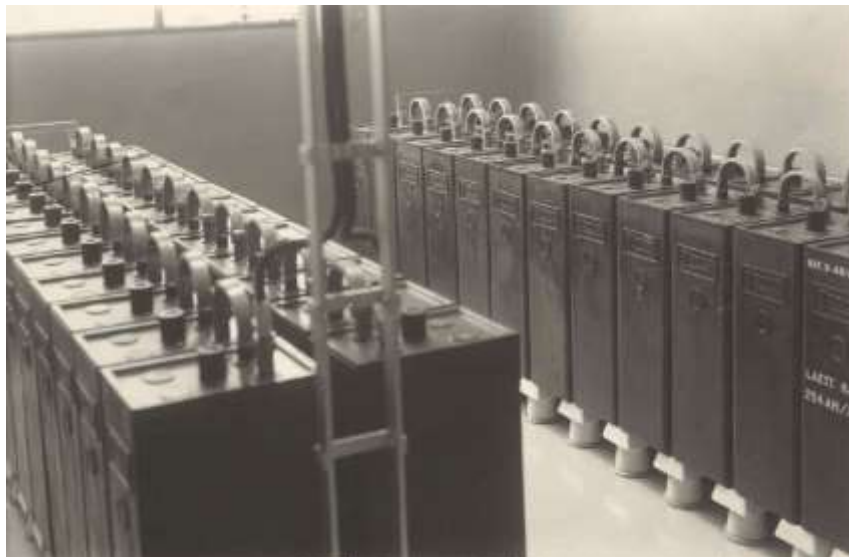
(139) Baterías de acumuladores en la sala de baterías de la Central 66 .
