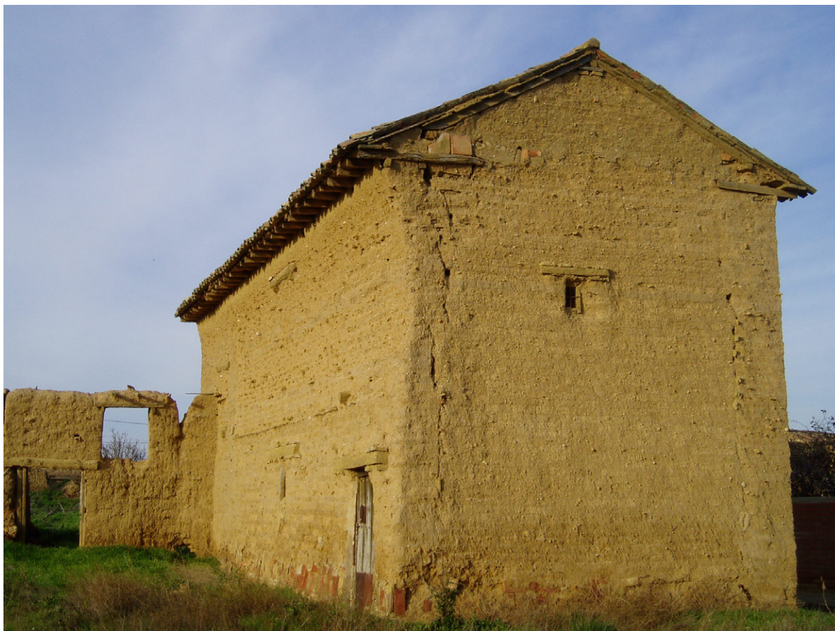
Boada de Campos (Palencia). Edificio de almacenamiento agrícola. Muros de tierra que nacen sobre el terreno en ausencia de zócalo. Destaca su integración en el entorno a través del uso de materiales del lugar, su masividad muraria y la ausencia de huecos
