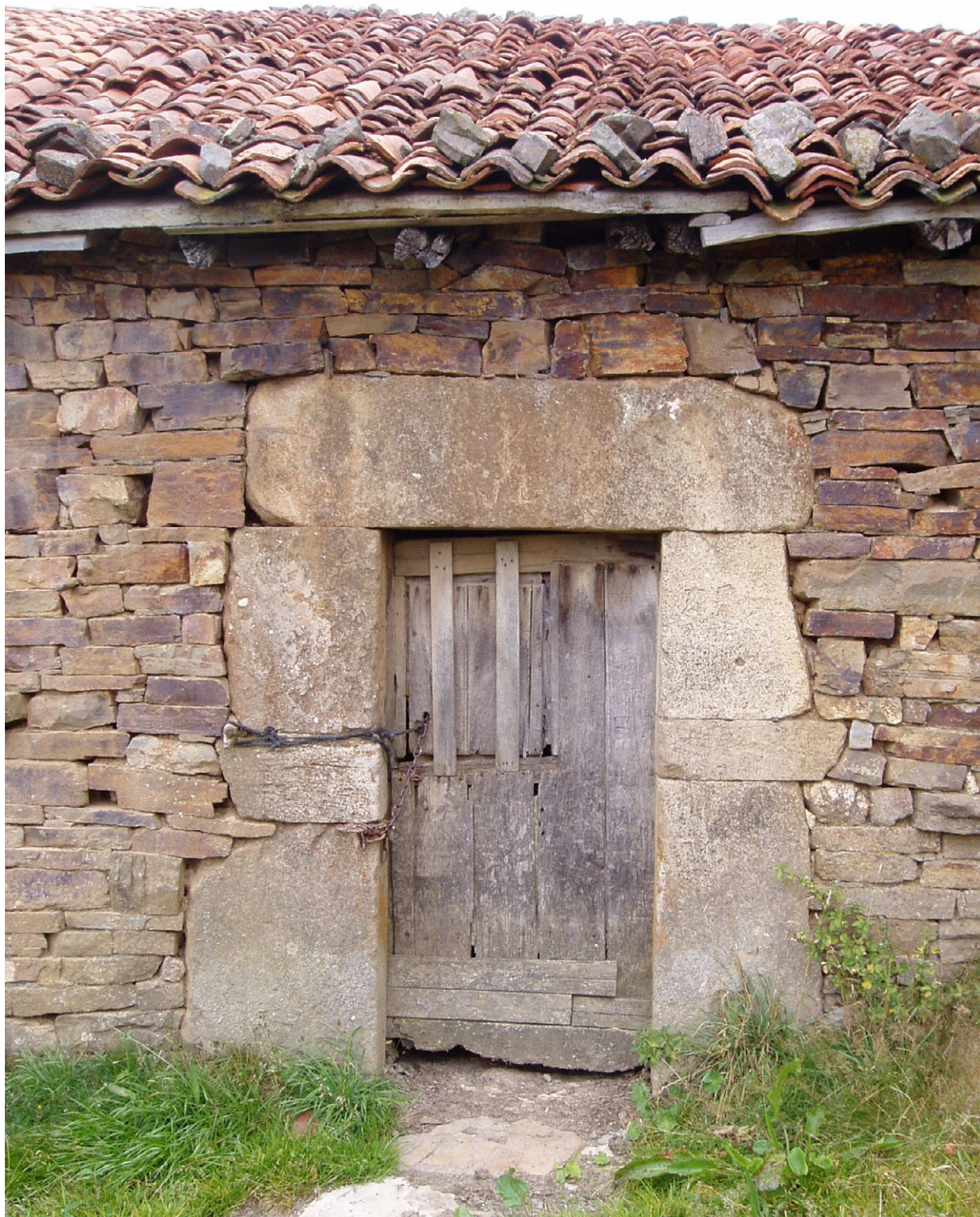
Cobijón (Santander). Construcción tradicional. Muro de mampostería de piedra asentada en seco, con dintel y jambas de la puerta ejecutados mediante sillares labrados de gran formato. La estructura de la cubierta de rollizos de madera y tabla sobre la que se asienta la cubierta de teja cerámica manual
