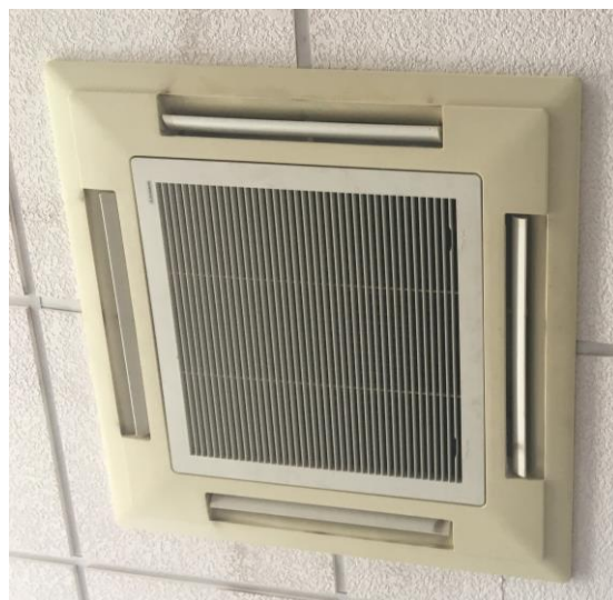
Figura 26: Unidad Interior empotrada en el techo.
