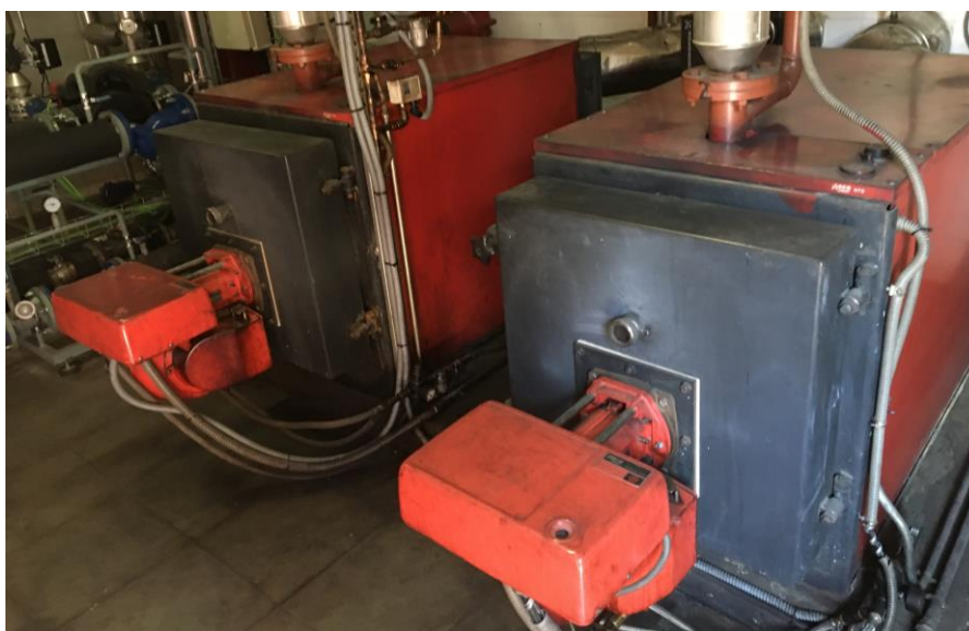
Figura 24: Calderas del Aulario.
