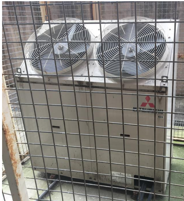
Figura 25: Unidades exteriores situadas en el Garaje del Aulario.
