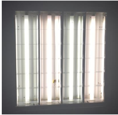
Figura 21: Iluminación artificial del edificio.
