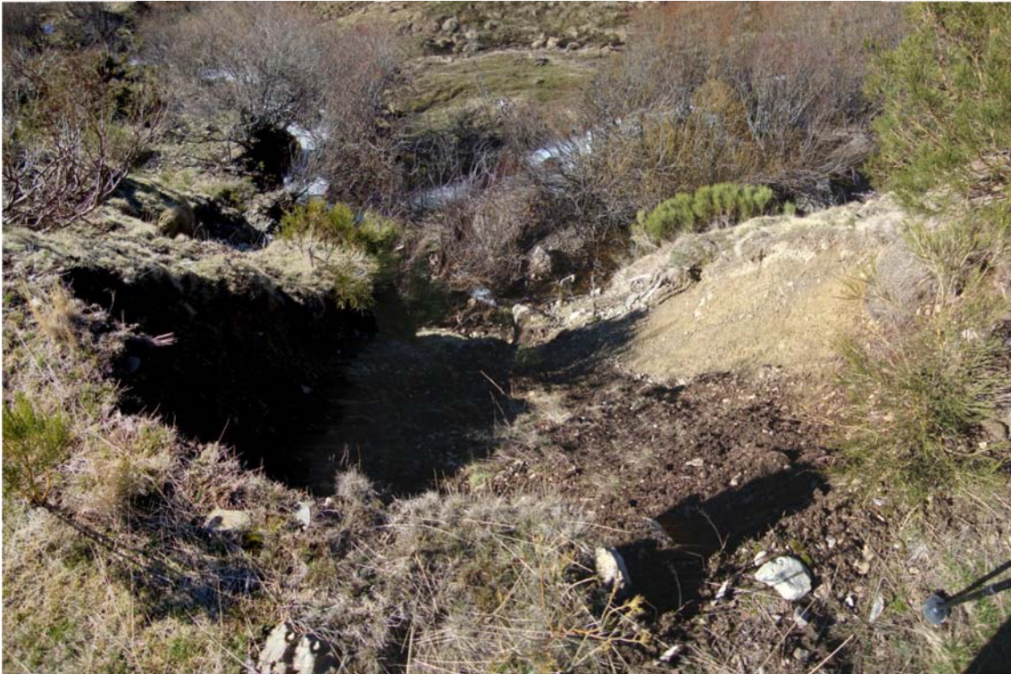
Figura 8.1: Pequeño deslizamiento en la margen izquierda del arroyo de Naranco, ocasionado por la erosión lateral del mismo.
