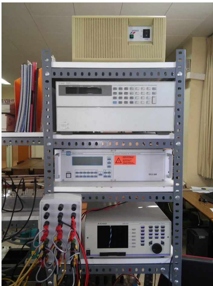
Figura 15: Conjunto de equipo auxiliar. Por orden descendente: Tarjeta DS 1103 PPC; carga electrónica HP N3300A; vatímetro 4-Channel Power Meter LMG450. Zona inferior izquierda: bornero de conexionado.
