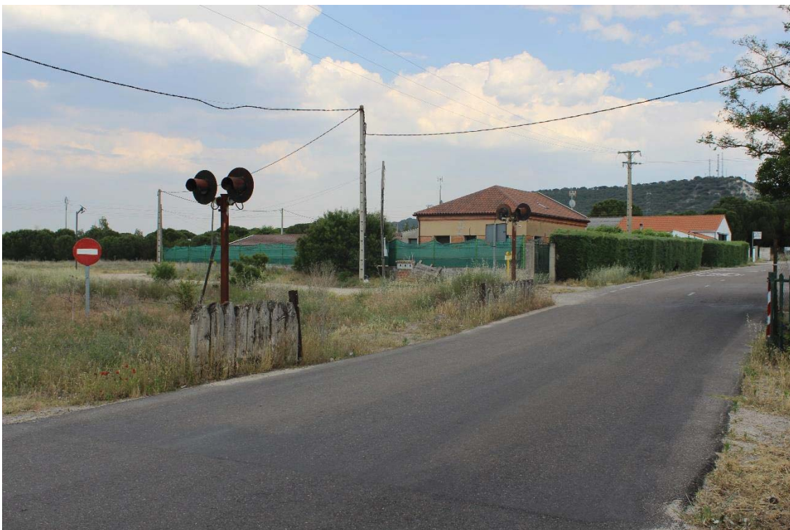
Paso a nivel desaparecido en Tudela de Duero, al haberse asfaltado por encima, a su vez se ven como todas las señales del ferrocarril están oxidadas y en un estado muy deteriorado. (Imagen propia)
