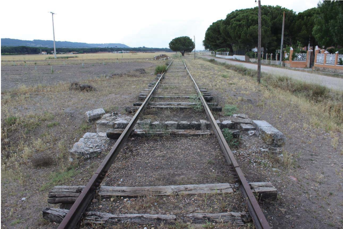
Tramo de la vía de Traspinedo, donde observamos que por su deterioro se han perdido diferentes traviesas y la totalidad de su balastro. (Imagen propia)
