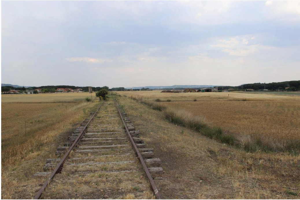
Paso de la línea por Traspinedo, la línea va recta, donde se aprecia el llano del territorio. (Imagen propia)
