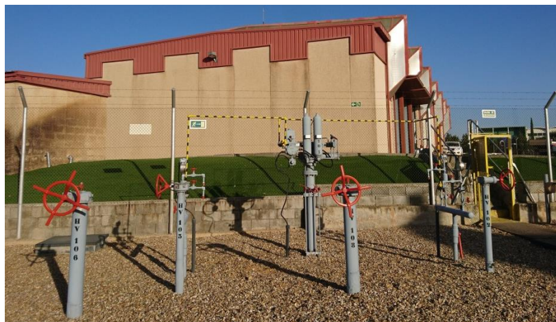
Figura 7. Estación de Seccionamiento y Corte
