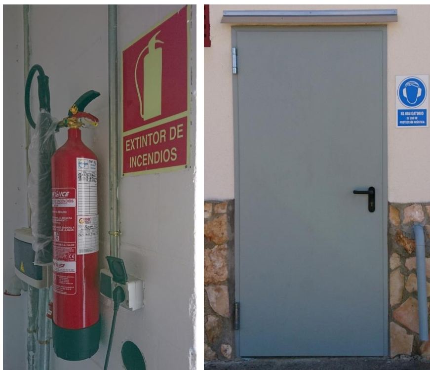
Figura 15. Señalización EPIs y Equipos de Extinción
