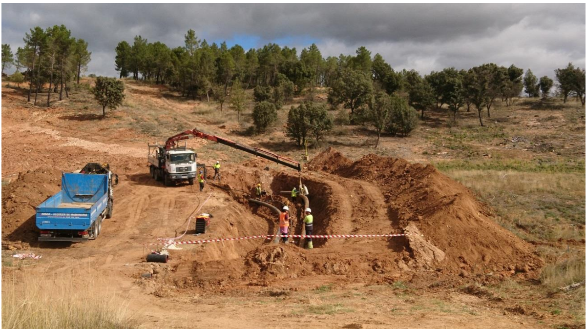
Figura 30. Conexión del gasoducto
