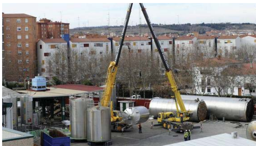
Ilustración 12. Maquinaria desmantelando los silos de la empresa de Lactalis. Fuente: El Norte de Castilla.
