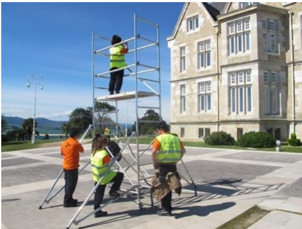
Figura 14. Prueba de toma de fotografías sobre andamio, para una posición más centrada con la fachada.
