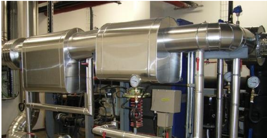
Imagen 31. Subestación de calor con aislamiento térmico en la valvulería. Fuente ADHAC.
