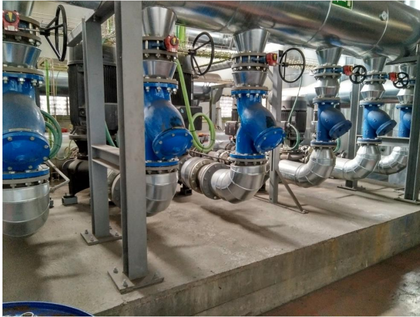
Imagen 54. Sistema de bombeo circuito secundario de la red del DH.
