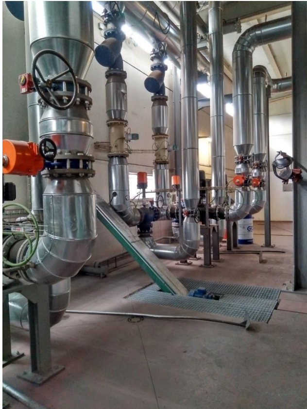
Imagen 53. Sistema de bombeo del circuito primario de cada caldera.
