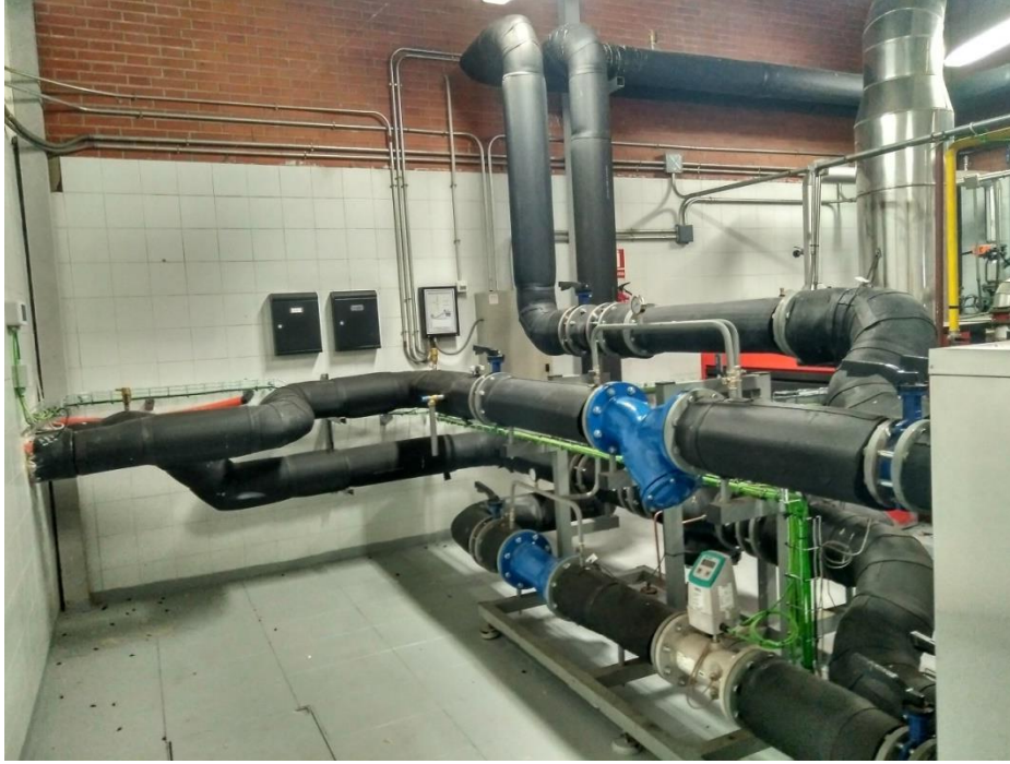
Imagen 61. Conexión entre circuito primario y secundario a través de la Subestación de la E.I.I.
