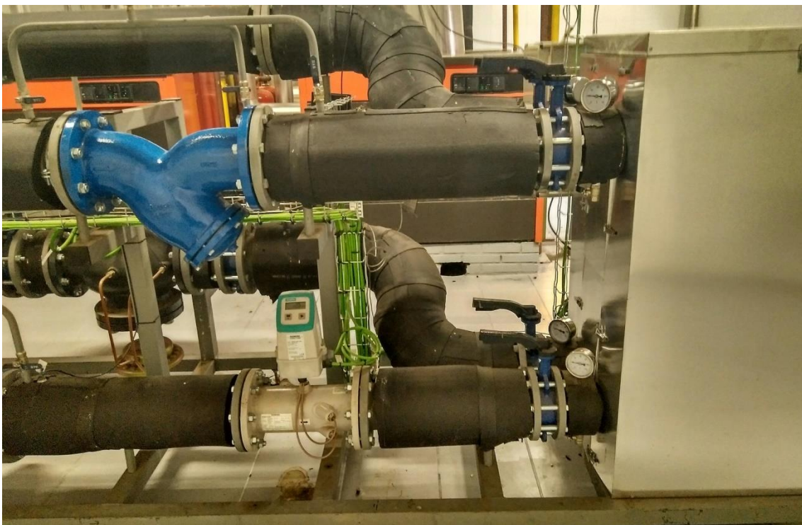
Imagen 63. Subestación de la E.I.I (2).
