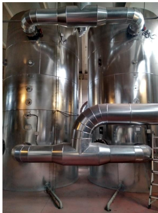
Imagen 52. Depósitos de inercia.
