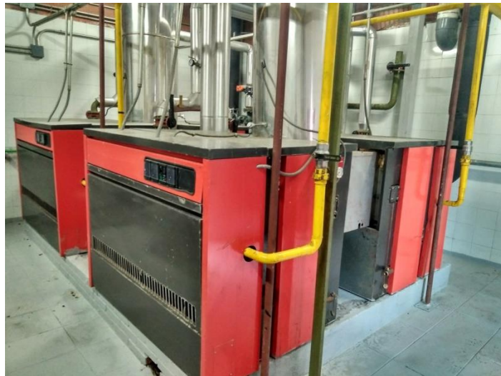
Imagen 65. Calderas de gas natural de la E.I.I.
