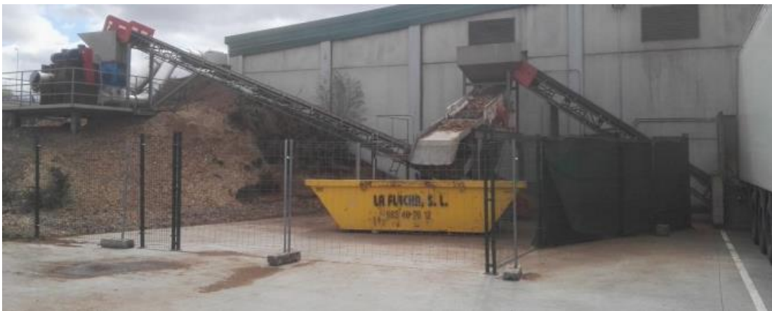
Imagen 39. Descarga de biocombustible al silo de almacenamiento.
