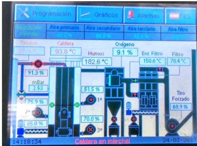
Imagen 66. Cuadro de mando de la caldera 2.
