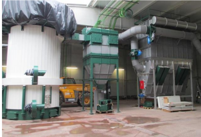
Imagen 43. Caldera - sistema multi-ciclónico- filtro de mangas.
