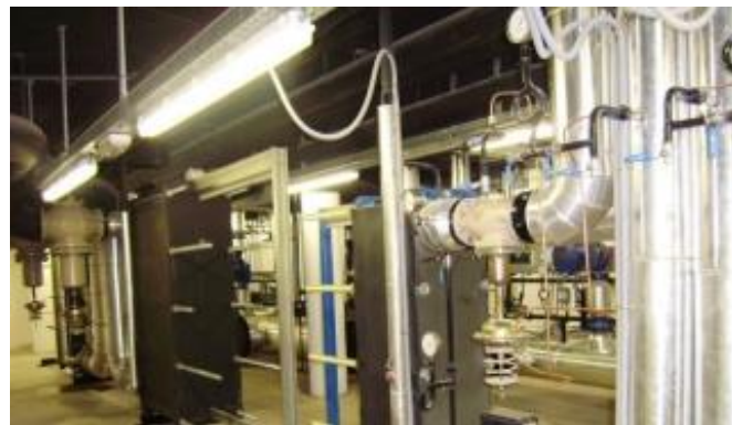
Imagen 32. Subestación de calor con aislamiento térmico en el intercambiador de calor. Fuente ADHAC.
