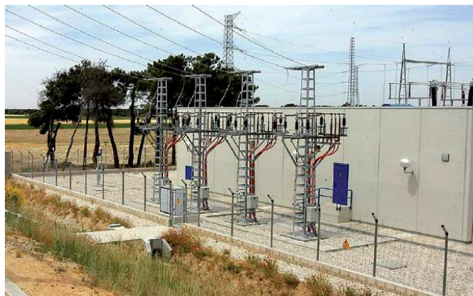
Imagen 4.8 - Pórtico de salida o de catenaria-feeder.
