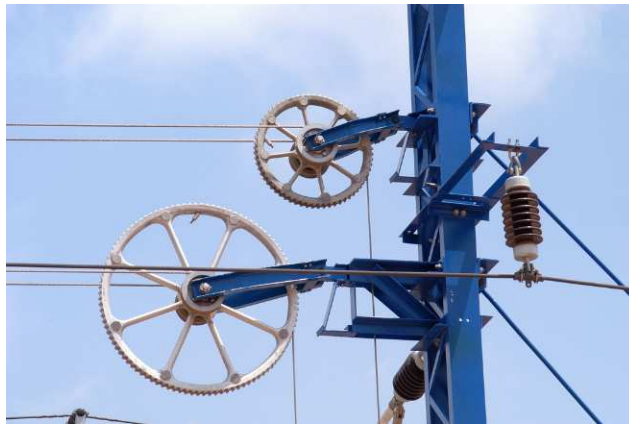
Imagen 4.11 - Sistema de compensación independiente de la catenaria.
