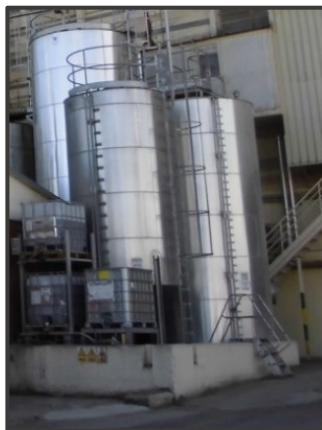
Figura 44: Tanques de acero inoxidable con su muro protector.
