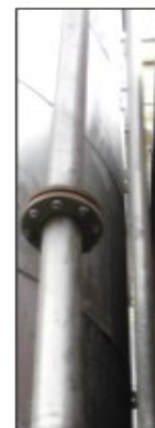
Figura 42: Tuberías de llenado.
