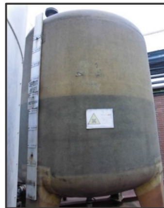
Figura 45: Tanque de agua.
