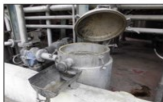
Figura 40: Pocete de descarga calefactado.
