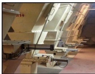
Figura 28: Silos de almacenamiento de materias primas sólidas en las fábricas de premolienda.
