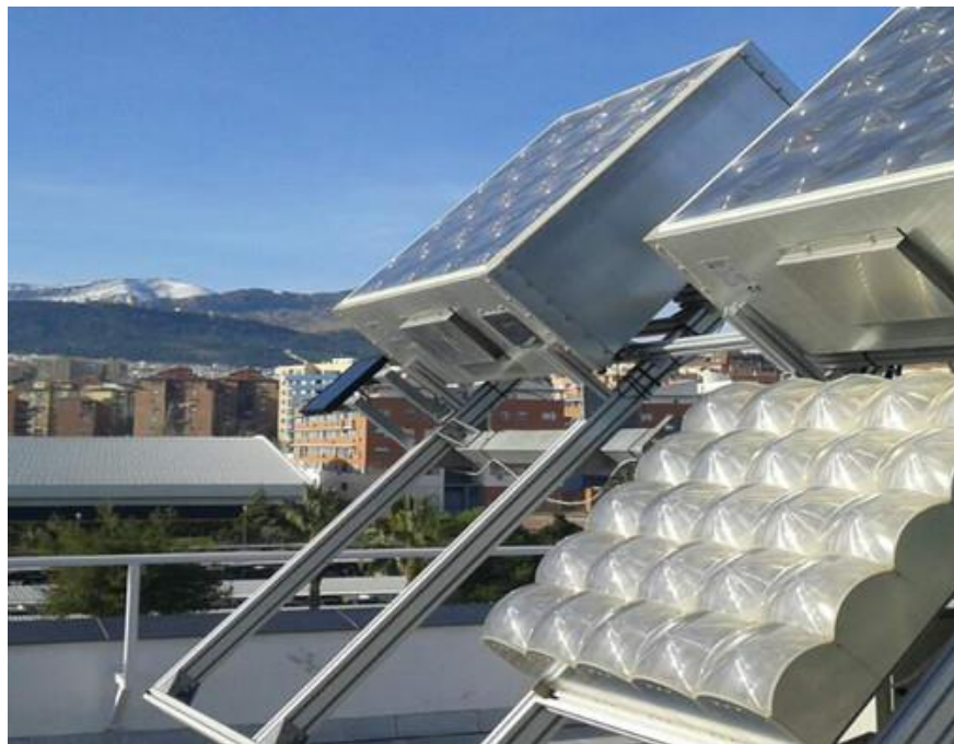
Imagen 3: Sistemas de concentración fotovoltaica en la cubierta superior de un edificio (Fuente: SIN, La Ciencia es Tecnología).
