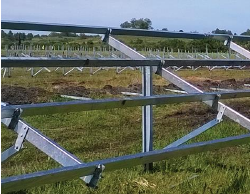
Imagen 16: Estructura soporte monoposte (Fuente: NClave.com).
