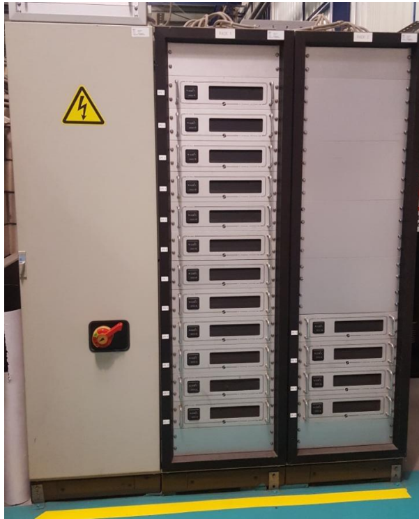
Ilustración 36: armario de control de la instalación.
