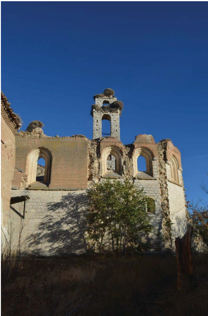
Fig. 45. Ruinas de un muro exterior de la iglesia. Fuente: autora.
