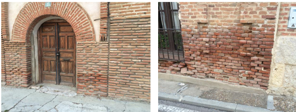
Imagen 148. Imágenes de edificios con presencia de humedad capilar y daños derivados de dicha presencia de humedad.
