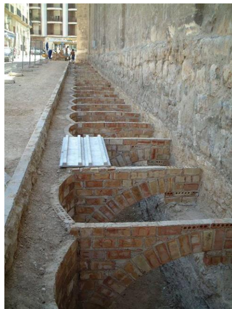
Imagen 11. Detalle de la ejecución de una cámara bufa, y estado final antes de proceder a su cubrición 53
