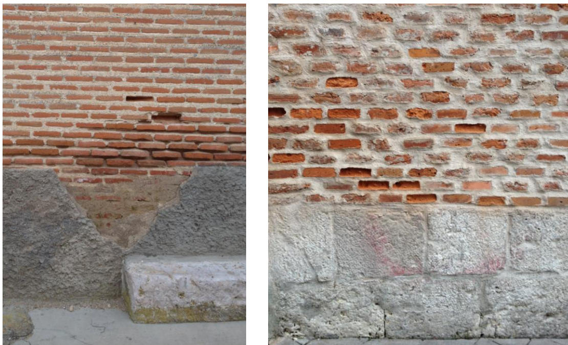
Imagen 42. Imágenes de fábricas similares a las estudiadas. Ejecutadas con ladrillo antiguo de tejar macizo y con juntas gruesas de argamasa de cal. Se aprecia el deterioro producido por la ascensión de agua por capilaridad, y por las incorrectas soluciones ejecutadas para su reparación.
