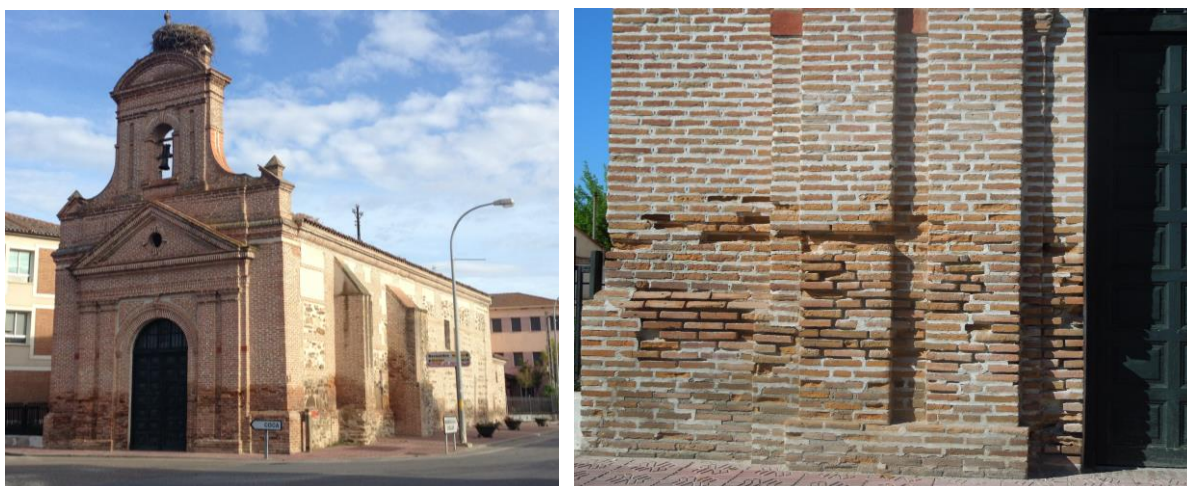
Imágenes 1 y 2. Ermita del Santo Cristo de la Expiración. Nava de la Asunción (Segovia). Se aprecian claramente los efectos estéticos y las lesiones provocadas por la presencia de agua capilar
