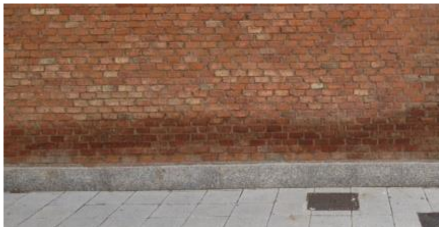
Imagen 44. Imagen de fábrica de ladrillo de tejar macizo colocado a tizón con presencia de humedad capilar. Se aprecia claramente la marca del frente húmedo
