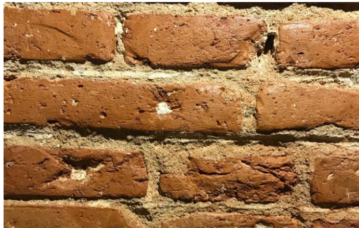
Imagen 19. Detalle de exfoliación de ladrillo de tejar por presencia de caliches superficiales
