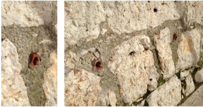
Imagen 12. Detalle de un higroconvector colocado en un muro de mampostería. Archivo Histórico de Simancas (Valladolid)
