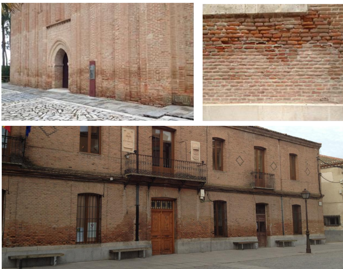
Imagen 43. Imágenes de fábricas de ladrillo de tejar macizo, del tipo de las estudiadas en esta tesis. Se puede apreciar claramente en todas ellas la cota alcanzada por el frente húmedo y las lesiones derivadas de la presencia de la humedad, agravadas por soluciones constructivas incorrectas.
