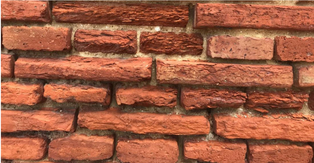
Imagen 16. Detalles de degradación de ladrillos de tejar por procesos de hielo-deshielo
