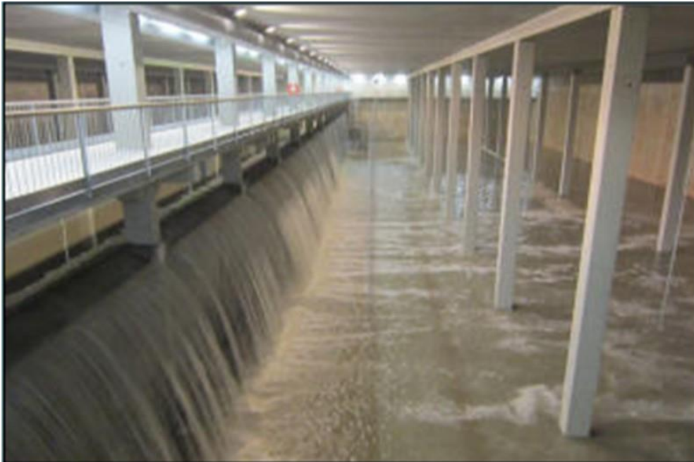
Imagen 50: Tanque anticontaminación de Alicante.
