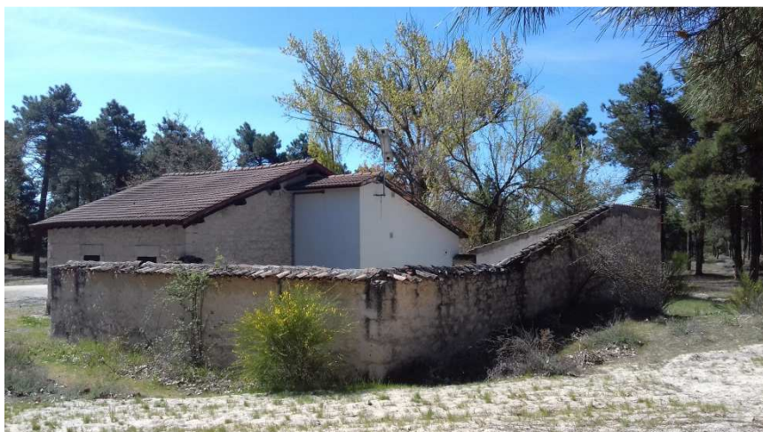
Figura 4. Exterior de la Casa del Guarda. Diferencias en el estado de conservación del edificio y el patio trasero.
