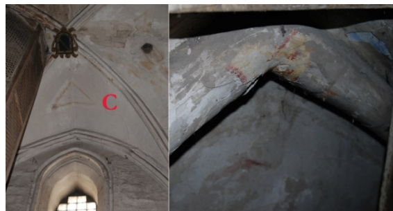
Fig. 22. Capilla del primer tramo con escalera de subida a Coro. Restos de pintura roja en bóveda y jambas de huecos.
