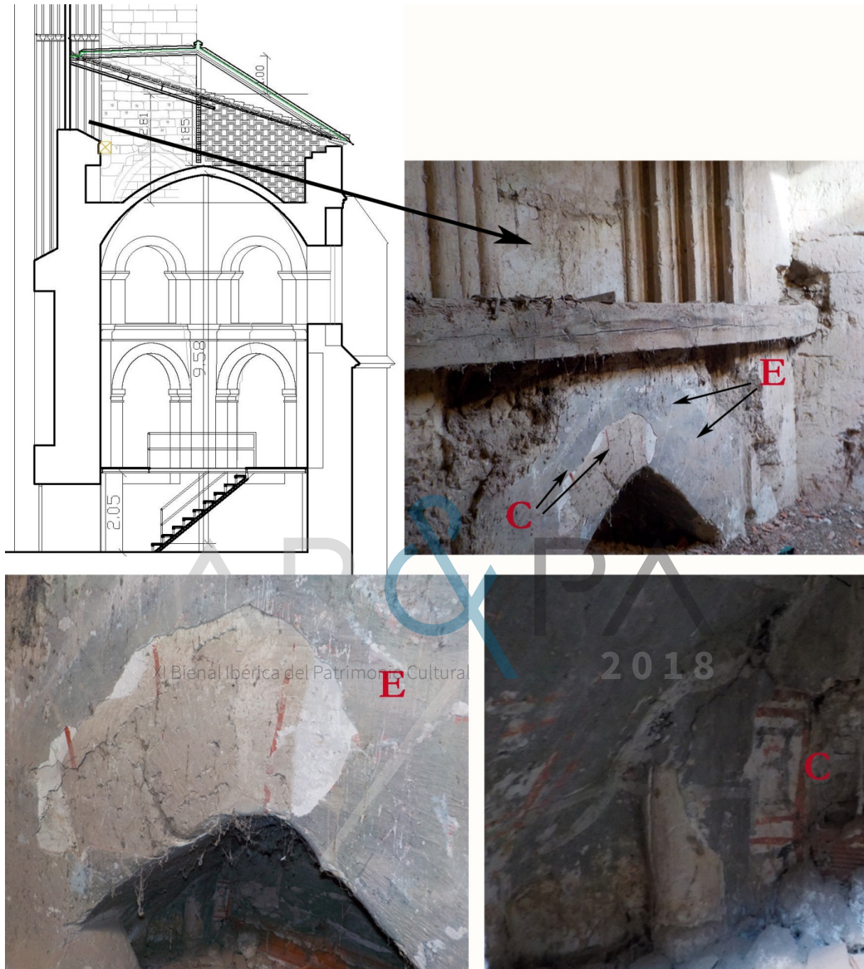
Fig. 25. Fotografías del bajo cubierta de Relicario. Detalles de restos de pintura en arco de ventana. Superposición de capas de pintura. . C. Pintura llagueado sillar junta ocre rojo s. XV. E. Sillares grises con llagueado simple color blanco.
