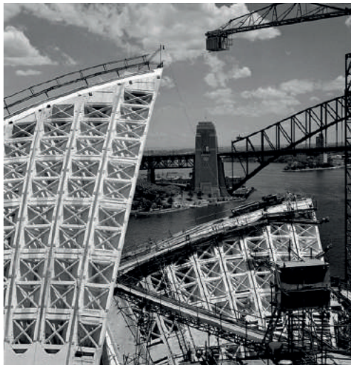
[] Construcción de las conchas de la Ópera de Sydney en abril de 1966 https://bit.ly/2XGjeNE
