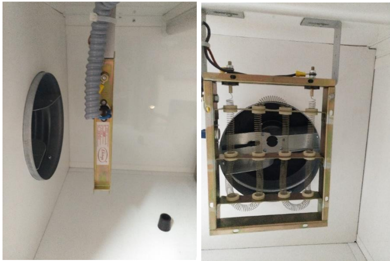
Figura 2.7: Vista lateral y frontal de la resistencia de precalentamiento.
