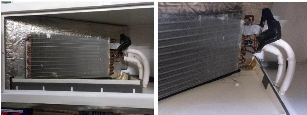
Figura 2.11: Intercambiador de la bomba de calor sobre cubeta de recogida de condensados.
