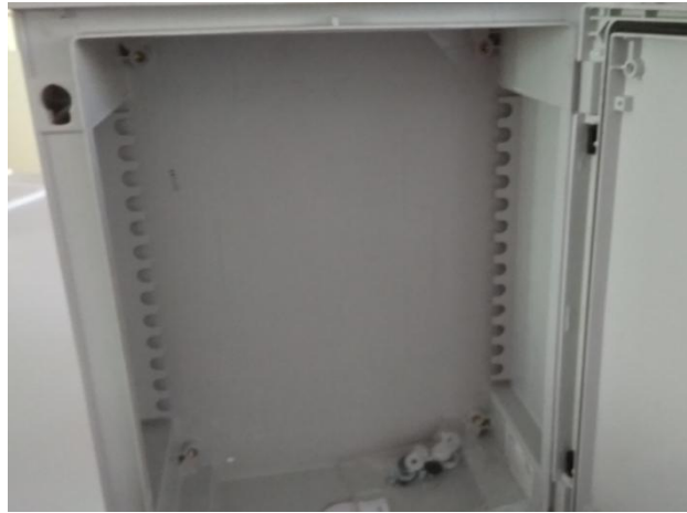
Fig. 47: Interior del armario
