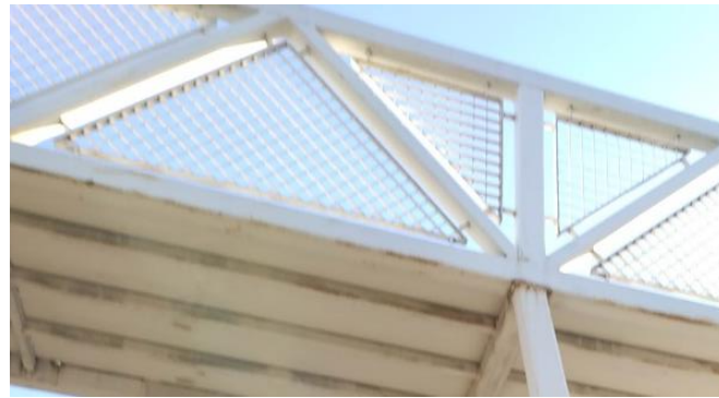
Ilustración 8- Rejillas del cerramiento
