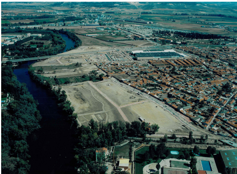
Figura V.3. Obras de acondicionamiento de la ribera del Pisuerga junto al Barrio España.
