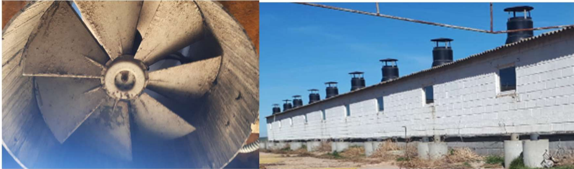
Ilustración 5. Ventilador en el interior de la nave y salidas de ventilación en la cubierta. Fuente: fotografía tomada en una de las visitas realizadas a la explotación.
