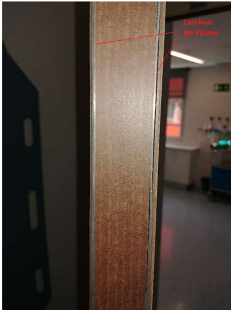
Figura 19: Perfil de la puerta del quirófano de vascular, que como vemos, tiene dos láminas de plomo de 1 mm cada una
