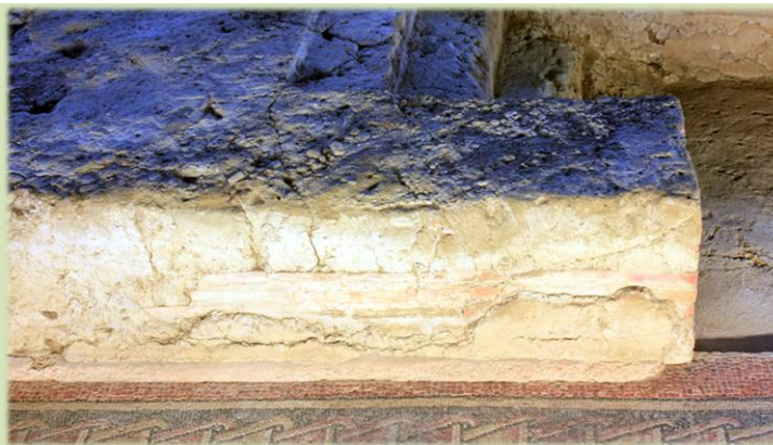
Figura 442: Zócalo de piedra y algunos ladrillos "testimoniales" en el acceso a la escalera sur y V-06. CGS.
