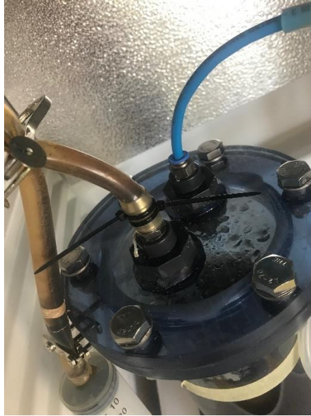
Ilustración 13: Detalle de los orificios sellados del digestor. Elaboración propia.
