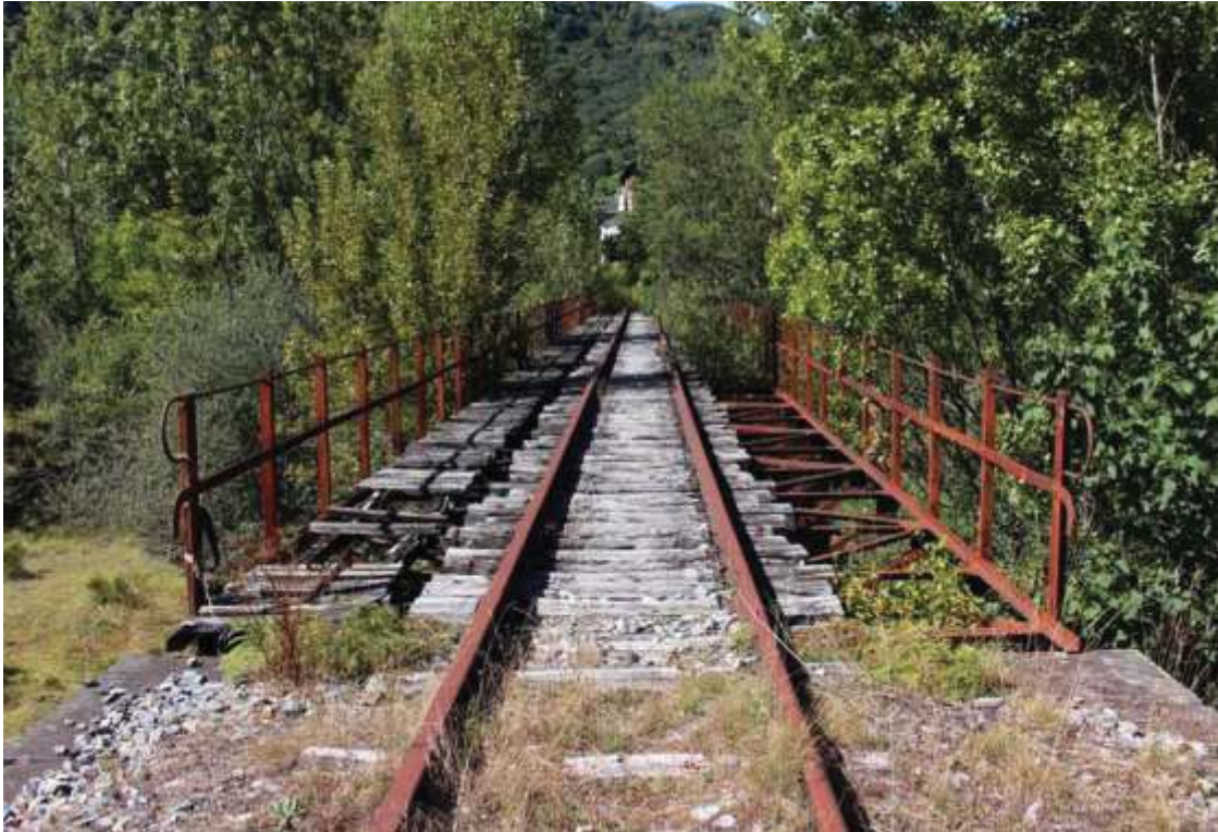
Puente abandonado de la línea Ponferrada - Villablino.
