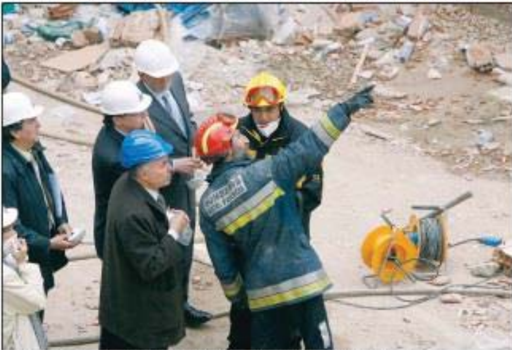
El estado de destrucción tras la explosión que por la Zona-Cero y también afectó a algunas de las torres por seguir trabajando en el Hospital de Burgos.
