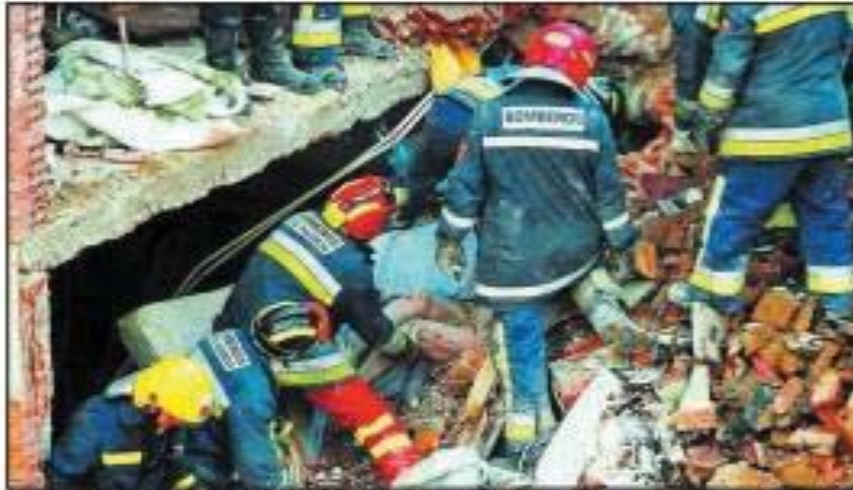
Los bomberos trabajan a una de las zonas más afectadas tras la explosión de Palencia. (Foto: AFP)
