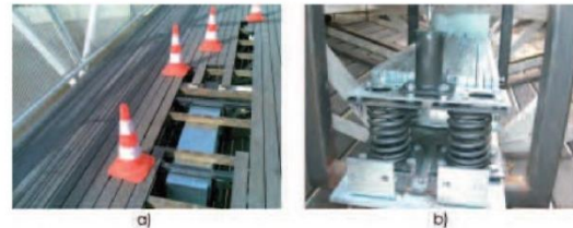
Fig. 7: a) Montaje temporal del TMD en el centro del vano 2 b) Detalle del TMD
