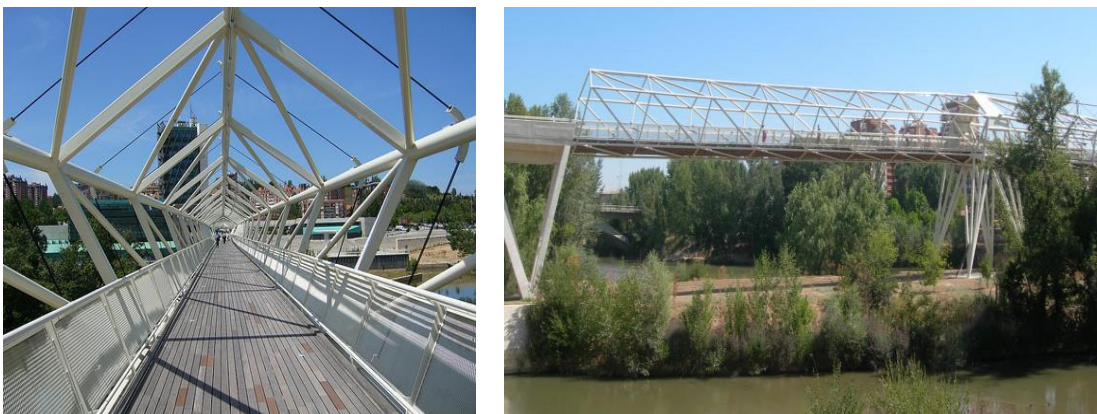
Figura 4.2 Detalles de la PMC de Valladolid: Sistema pretensado del vano 3 y su ausencia en el vano 2 de 51 metros.
