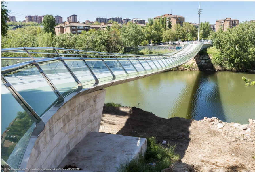
Figura 4.3 Vista general de la pasarela del Doctor Pedro Gómez Bosque (PPGB) de Valladolid
