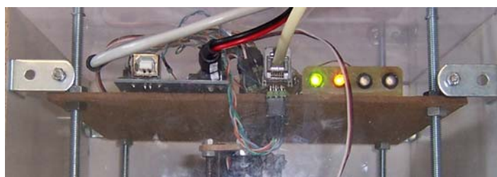
Figura 4-70: Parte frontal de indicadores y conexiones.
