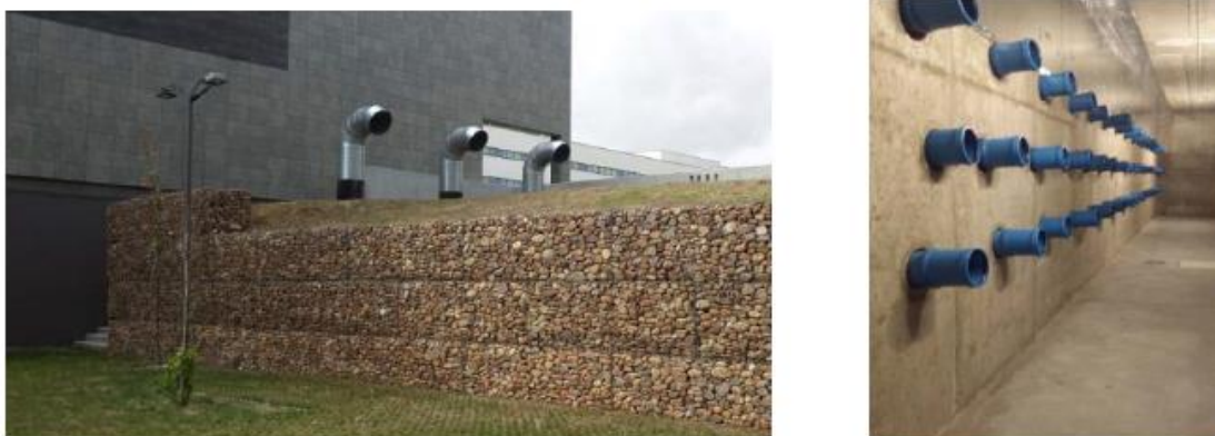
Figura 2.15: intercambiador tierra-aire del Edificio Lucía, en el Campus Delibes de la Uva. [2]
