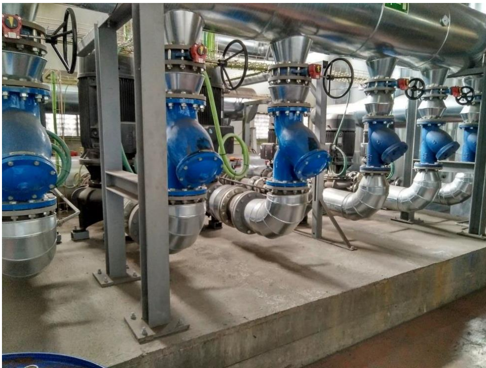
Figura 37. Sistema de bombeo de las dos redes que abastecen al DH de la UVa. Fuente: [34]
