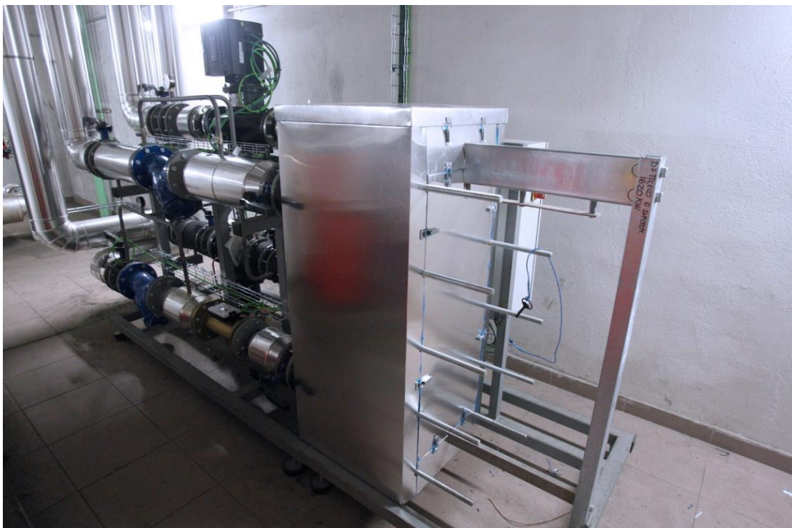
Figura 13. Intercambiador de una subestación de un DH. Fuente [25].
