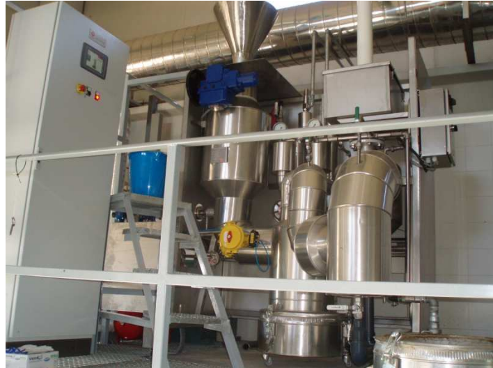
Figura 3.7. Planta piloto de pre-tratamiento térmico Cambi®
