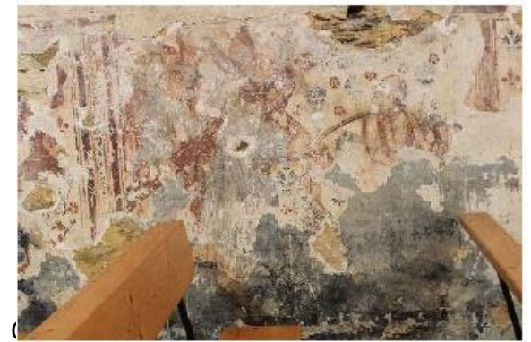
84. Mural deteriorado por el roce de los
