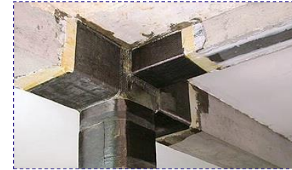
ilustración 1: unión estructural reforzada con fibra de carbono. Fuente: www.carrillodavila.com (2020-05-21).
