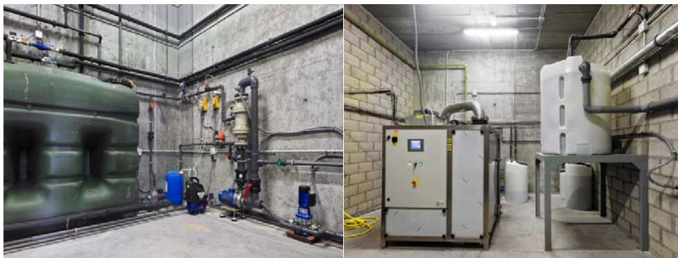
Figura 4.31 Vista de la sala de tratamiento de aguas grises (izquierda), y de la sala de tratamiento de aguas de laboratorios (derecha)
