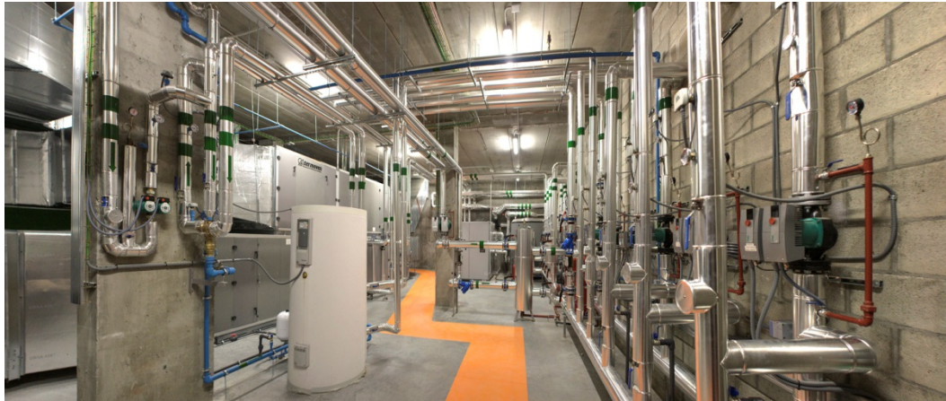
Figura 4.30 Vista de la sala del climatizador con los circuitos de distribución de calor en primer plano a la derecha
