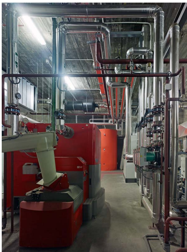
Figura 4.25 Vista de la sala de caldera auxiliar, con el alimentador de astillas y la caldera en primer plano a la izquierda y los sistemas de distribución a la derecha. Al fondo se encuentra el depósitos de acumulación de agua fría
