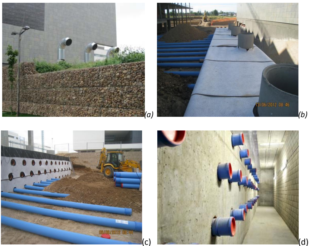
Figura 4.19 Diferentes fases de la construcción de los pozos canadienses: (a) remates de las tomas de aire exterior hacia el plenum de entrada, (b) entrada de las tomas de aire exterior al plenum previo a los tubos; (c) colocación de los tubos en el terreno; (d) plenum de entrada al edificio.
