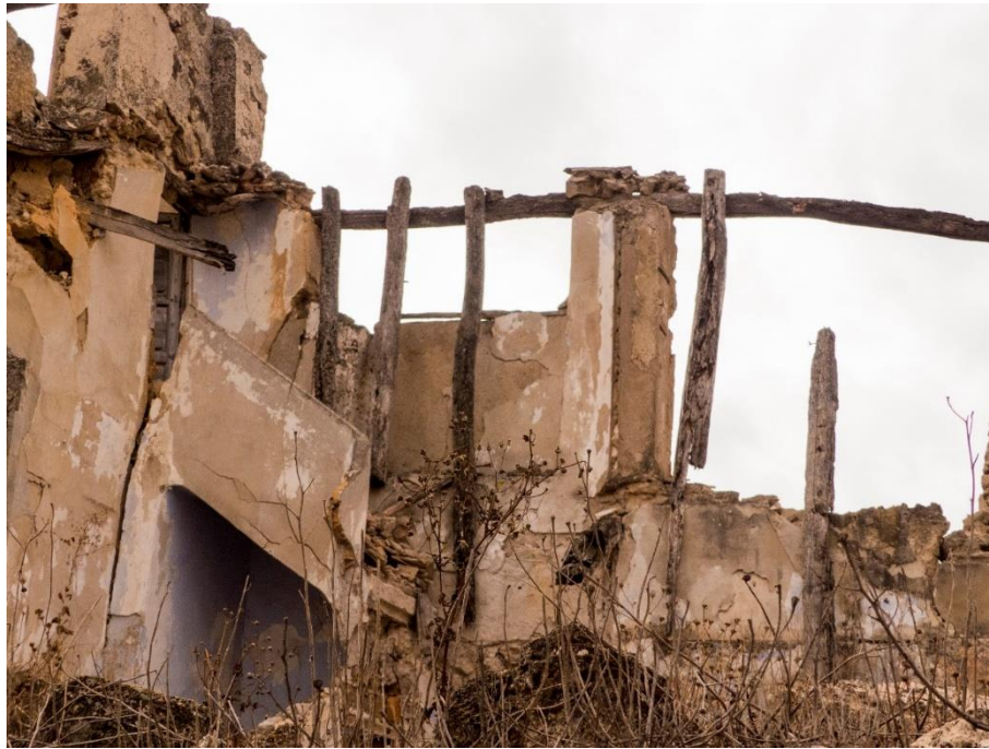
Figura 160. Vigas de chopo en una construcción en ruinas en Calamocha. Imagen propia.
