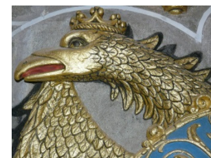
Figs. 99, 100 y 101._ Estado inicial de conservación y estado final tras los trabajos de restauración y dorado. Restauración del interior de la Catedral Nueva. Detalle escudo.
