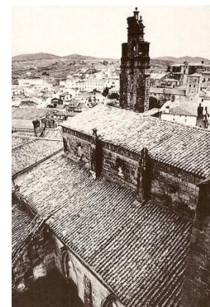
Fig. 40._ Estado de las cubiertas de la Catedral Antigua antes de la intervención de 1981.
