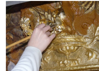
Fig. 107._ Proceso de dorado, colocación de la hoja de oro y aplacado. Restauración del interior de la Catedral Nueva. Detalle portada de acceso a la sacristía.
