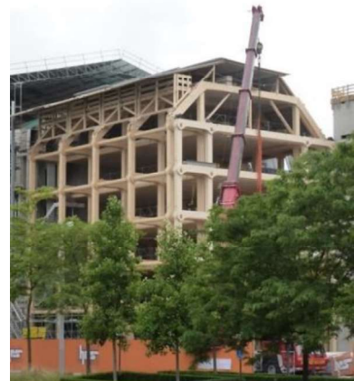
Fig. 84. Fase de estructura durante la construcción del edificio Tamedia Building en Zúrich. Fuente: https://cutt.ly/QmuFfs5
