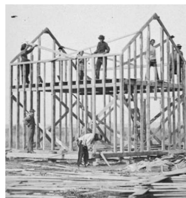
Fig. 17. Montaje de la estructura ligera según el sistema de globo en Estados Unidos. Fuente: https://cutt.ly/BmzdVlv
