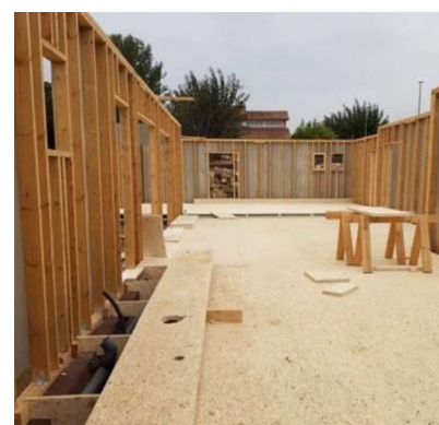
Fig. 73. Fotografía de una obra durante la fase de estructura, empleando montantes del producto estructural LSL. Fuente: https://woodify.es/producto/lignumstrand-lsl/
