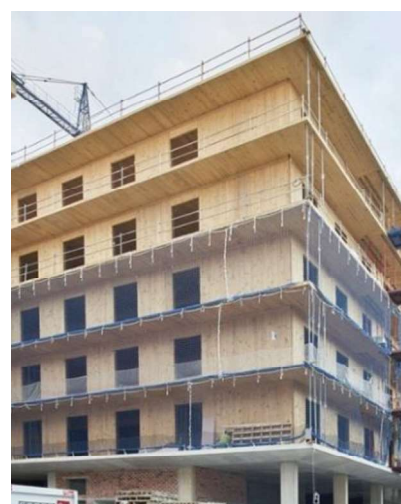
Fig. 93. Fase de construcción del edificio de 85 viviendas en Cornellá, Barcelona. Fuente: https://cutt.ly/gmoYcmU
