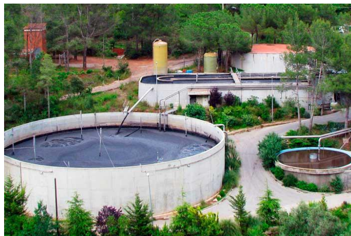
Figura 4: Zona de decantación secundaria EDAR
