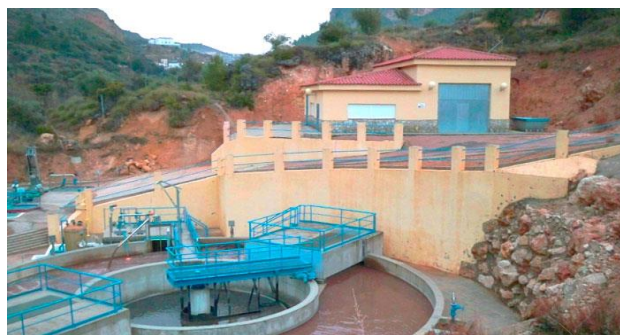
Figura 3: Zona de decantación primaria EDAR
