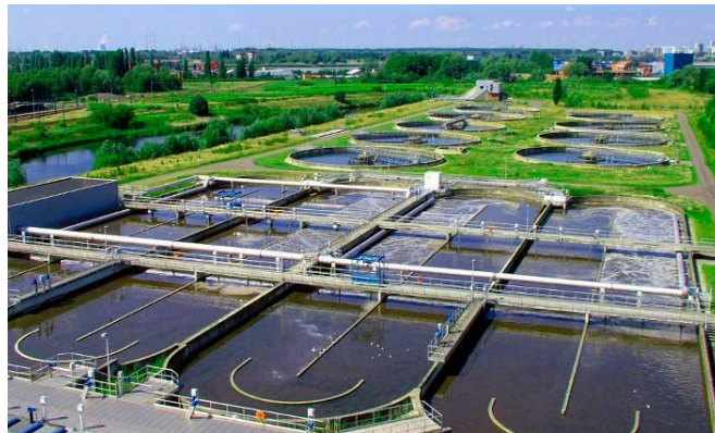
Figura 2: Zona de pretratamiento EDAR
