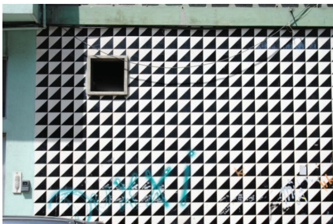
Fig. 208 - Detalhe dos azulejos do edifício da Rua do Bonfim, 1955. Arq. Mário Bonito.
