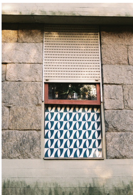
Fig. 217 - Detalhe de azulejos de edifício do conjunto habitacional do “Luso-Lima”. Rua da Alegria, Porto, 1960-1963. Arq. J. Carlos Loureiro e L. Pádua Ramos.
