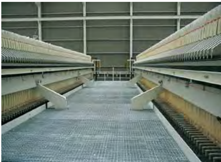
Imagen 10. Detalle de una instalación de filtros prensa
